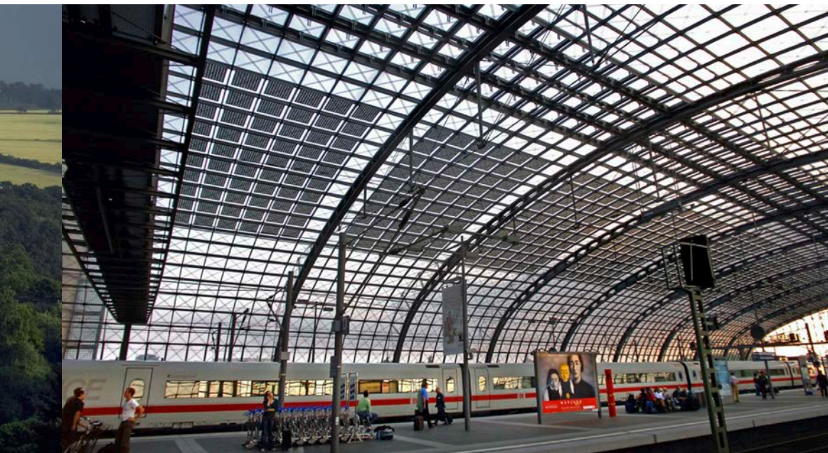
Photovoltaik auf dem Dach des Berliner Hauptbahnhofs
